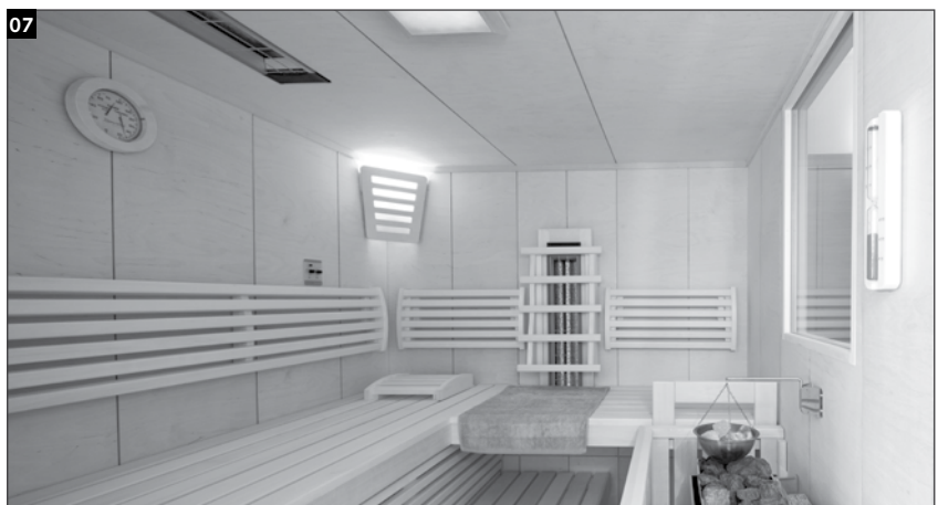
Bündiger Einbau eines 1300 Watt Strahlers in die Decke und Einbau eines 500 Watt Strahlers in die Sauna Wand.
