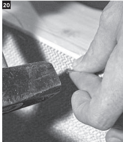
20 Beim Bedienungspaneel die Leibung, in die später der Strahler montiert wird, mit der Brandschutzmatte längsseitig mit Hilfe der mitgelieferten Nägel auskleiden.
