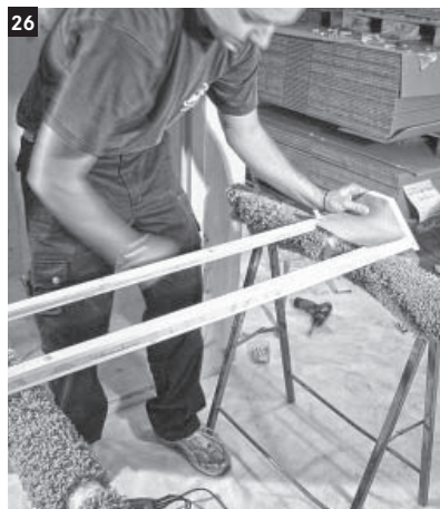
26 Als nächstes die Strahlerpaneele zur Hand nehmen und mit dem Brandschutz auskleiden.
