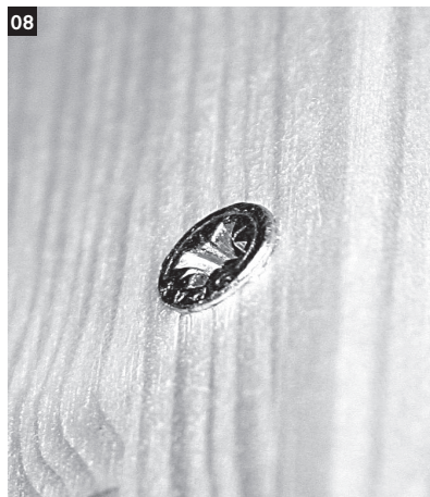
08 Alle Schrauben im Sichtbereich werden später mit Abdeckkappen abgedeckt. Daher nicht ganz in das Holz versenken!
